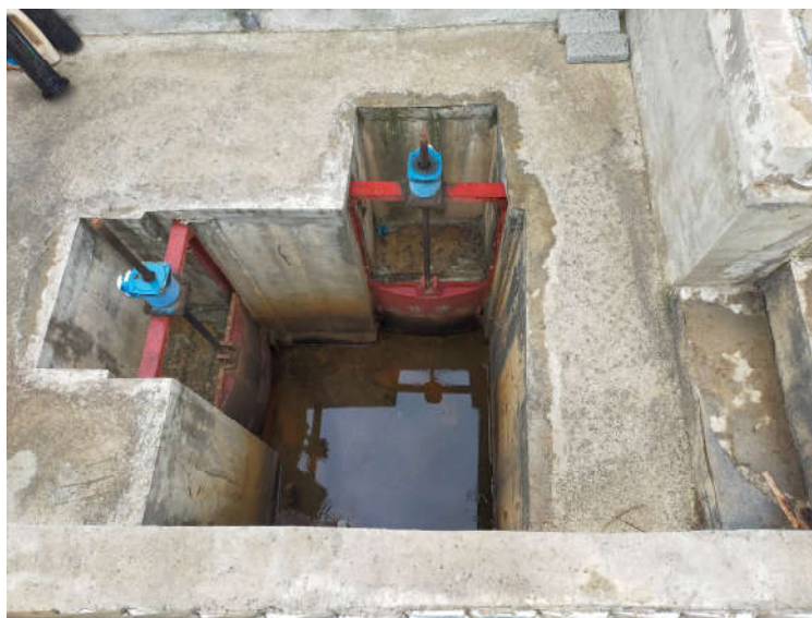
图4-16 初期雨水收集系统及雨水切换阀
