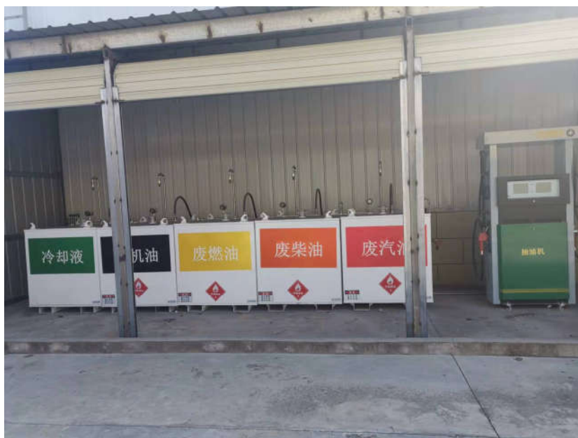
图4-6 废油液暂存设施
