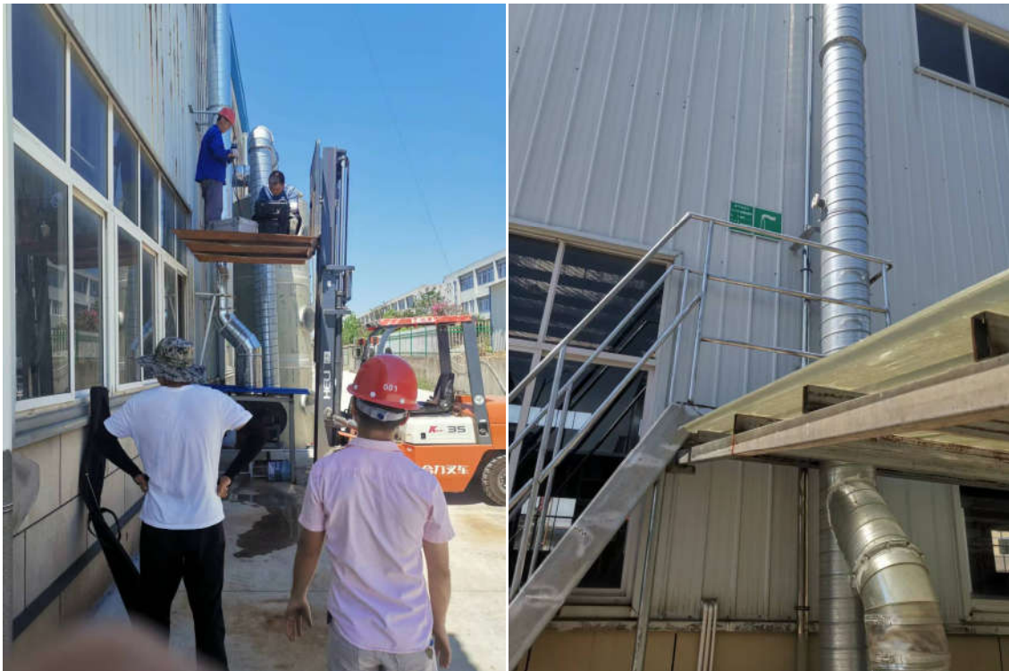
图4-9 车架拆解车间废气治理装置
